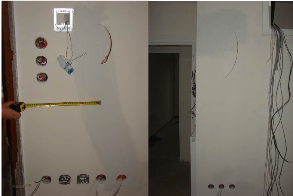
Εικ.34 Συρμάτωση και συγκέντρωση απολήξεων στο σημείο συγκέντρωσης
