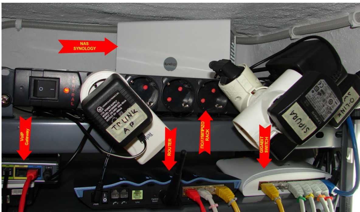
Εικ.60 Δεύτερο & Τρίτο επίπεδο rack
