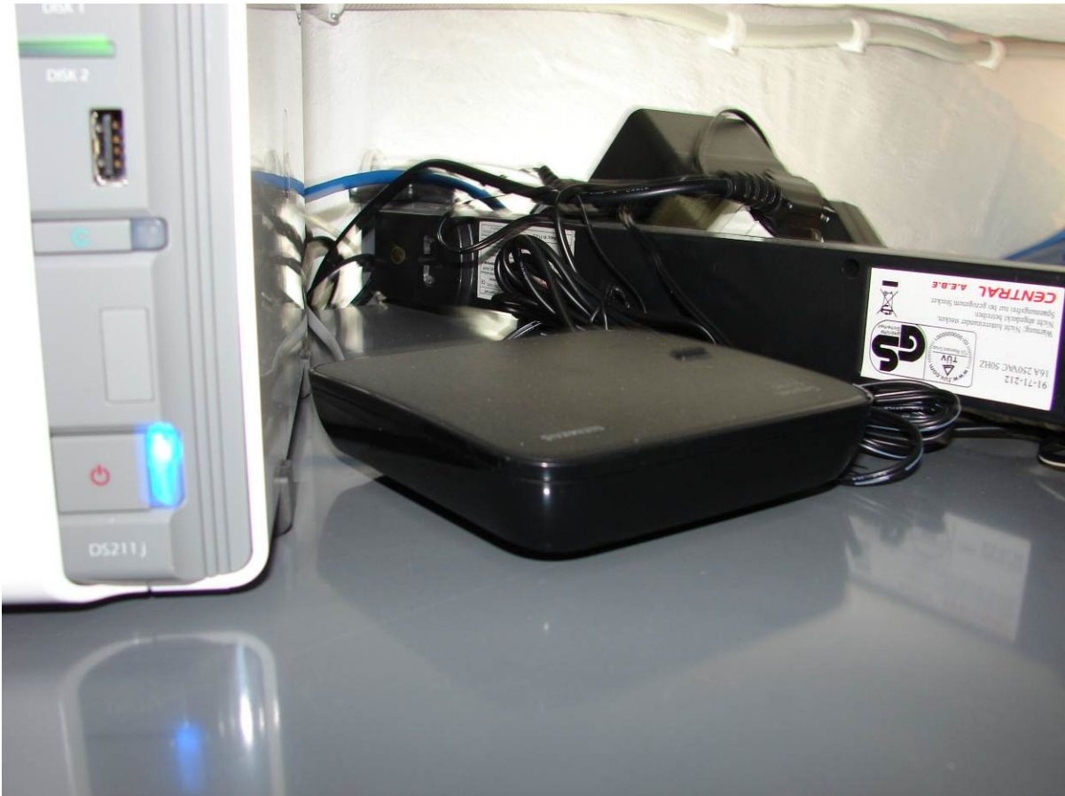
Εικ.61 NAS & σταθμός ασύρματου τηλεφώνου στο Rack
