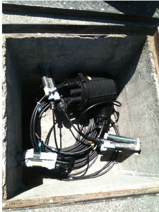
Εικόνα 7: Φρεάτιο με μούφα και περίσσεια καλωδίου
