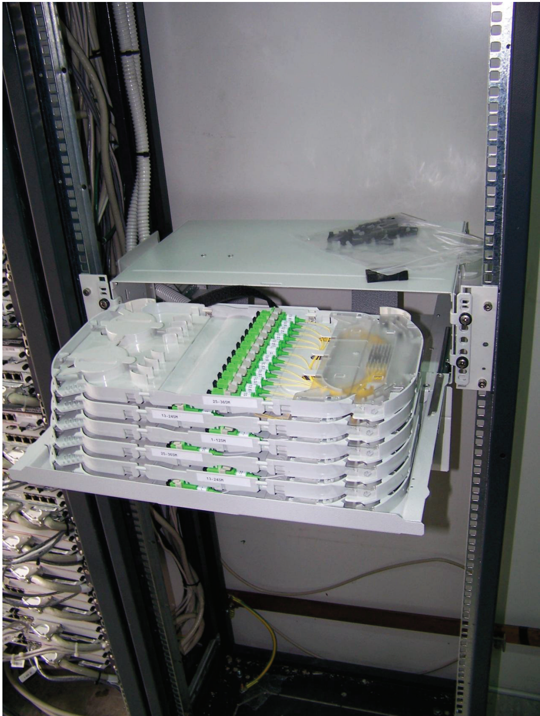
Εικόνα 40: Οπτικός κατανομητής σε hub (β)
