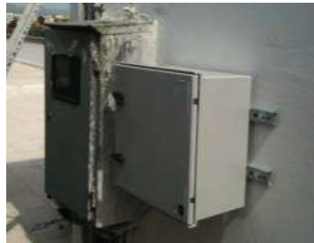
Εικόνα 24: Εγκατάσταση οπτικού κατανομητή (ε)
