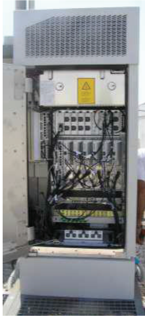
Εικόνα 21: Εγκατάσταση οπτικού κατανεμητή (β)
