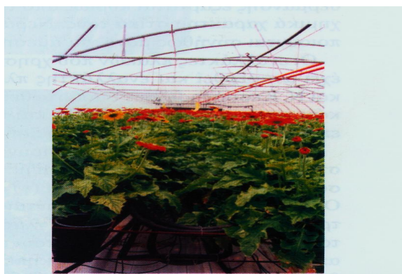
Σχήμα 7.7 Θέρμανση θερμοκηπίου με πλαστικούς αγωγούς PP με πτυχώσεις σε θερμοκήπιο λουλουδιών σε γλάστρες στο Σιδηρόκαστρο.
