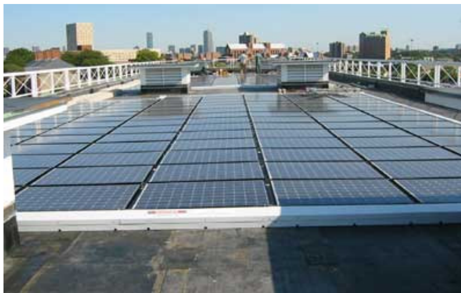
Σχήμα 2.1 Συστοιχία φωτοβολταϊκών στην οροφή κτιρίου.
