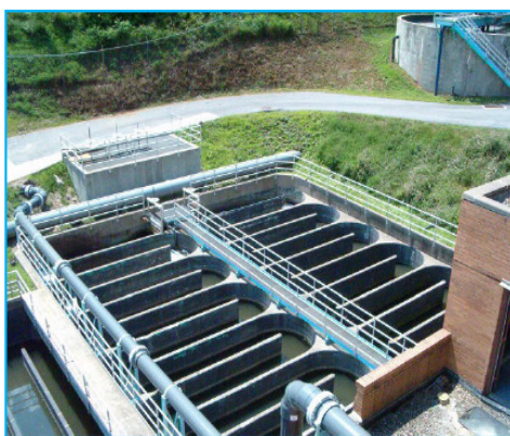
Εικόνα 3-11 : Μαιανδρικές δεξαμενές χλωρίωσης
